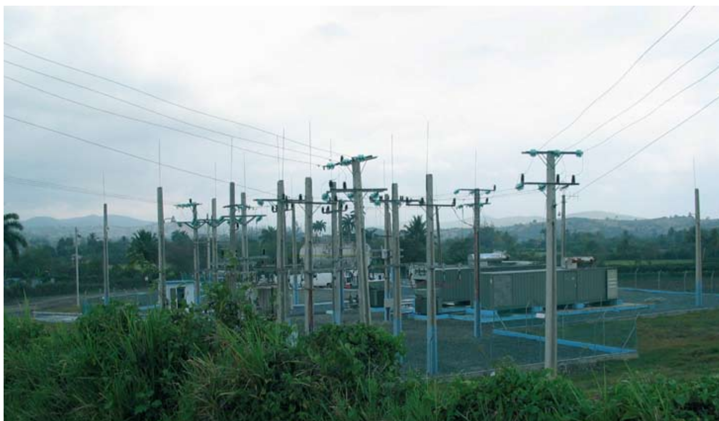
Distribuzione energia, Cuba - Power distribution, Cuba
