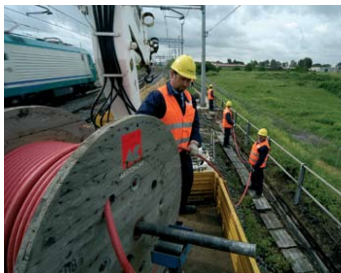
Alimentazione rete ferroviaria - Railways power supply
